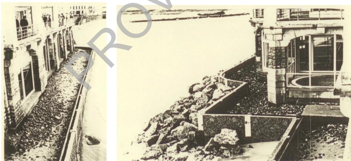
Figure 13 : Dégâts sur la façade de la Pergola à la suite de l'évènement du 30 janvier 1990
