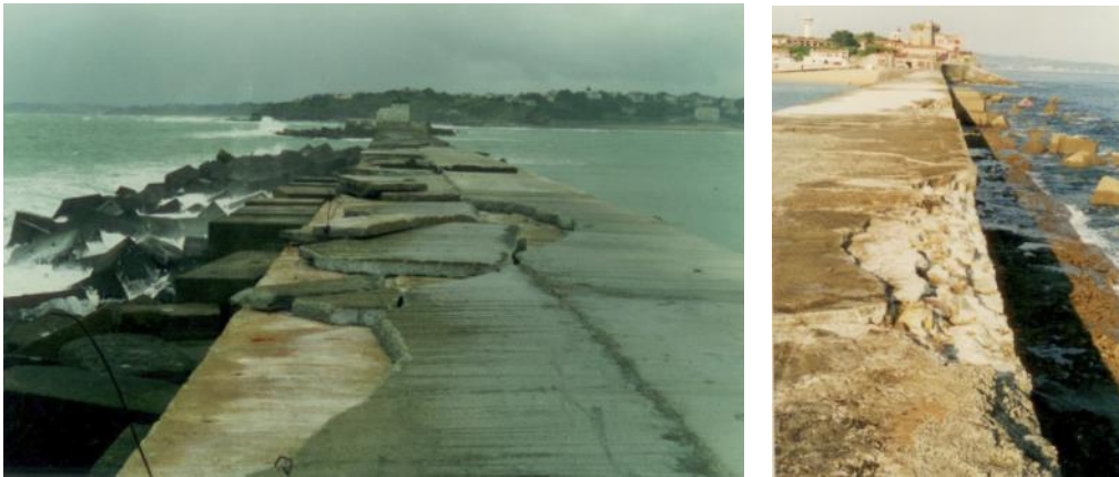
Figure 14 : Dégâts causés par la tempête de Décembre 1999
